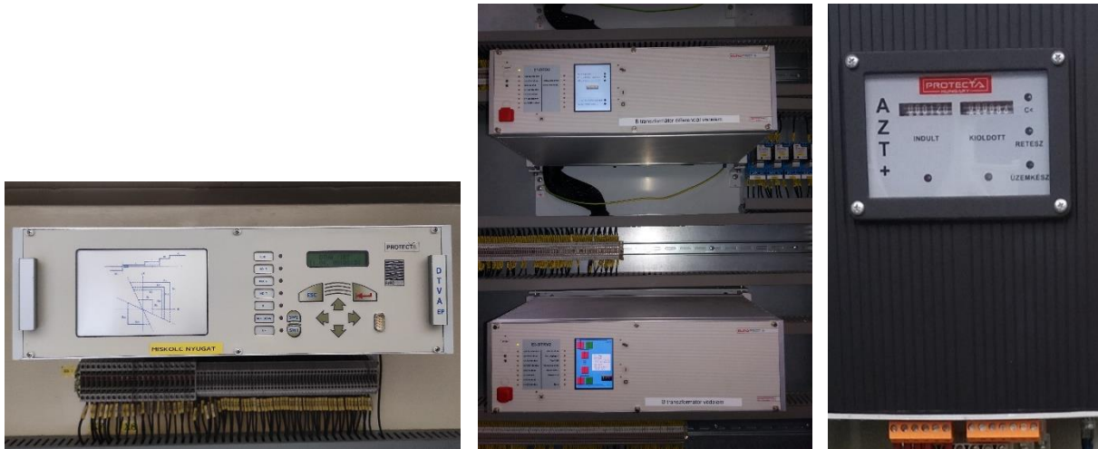
6. ábra: Protecs DTVA-EP távolságvédelem; Digitális transzformátor (E3-DTRV2) és differenciálvédelem (E1-DTD2); AZT+ tartalékvédelem.
