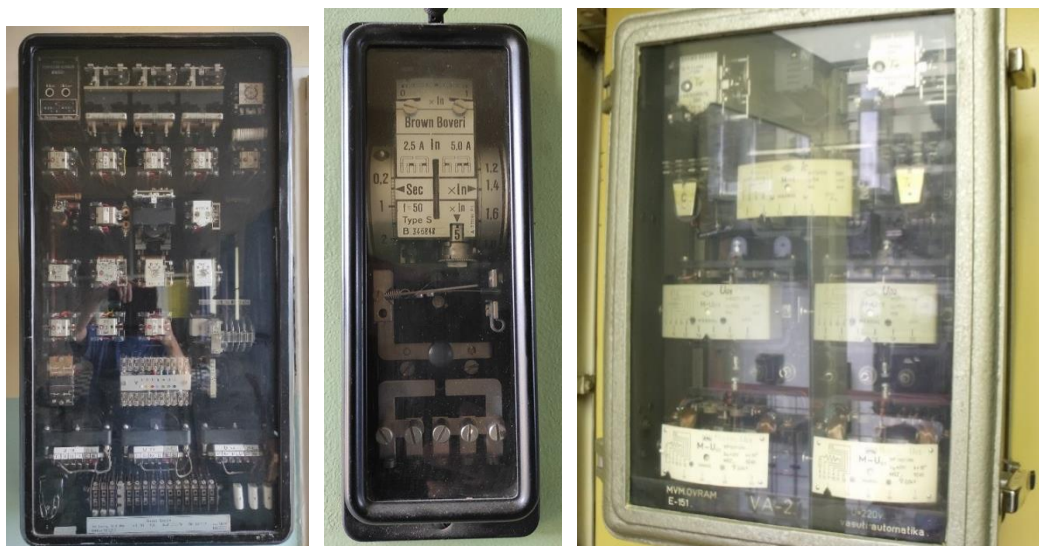
4. ábra: BBC-L3 távolságvédelem; BBC-S gyorsfokozattal rendelkező túláramvédelem; VA-2 típusú vasúti potenciálvédő automatika.
