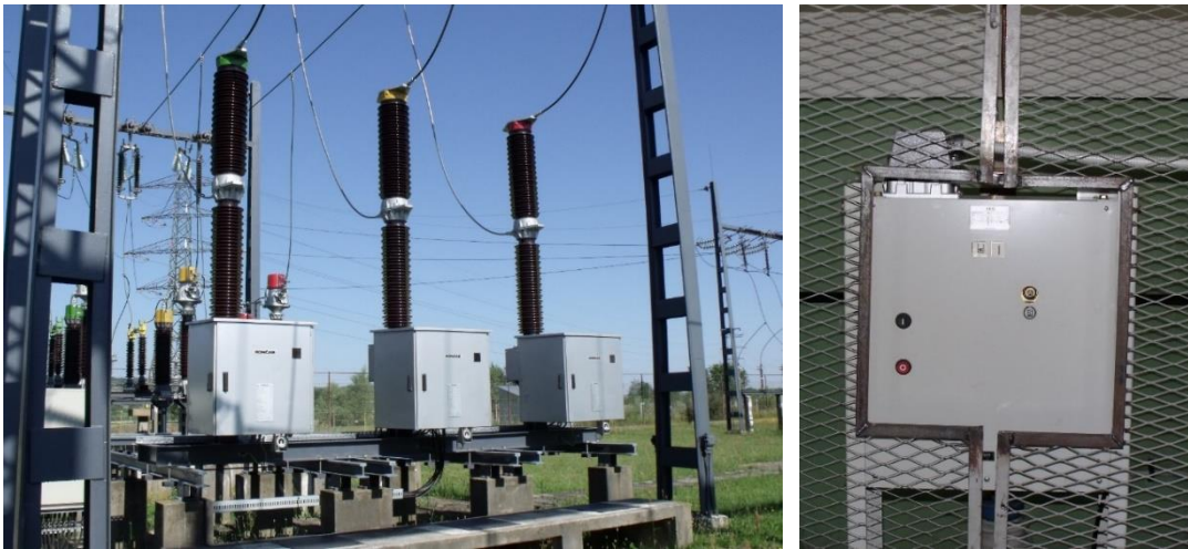
5. ábra: 7E1/13/C1024 A Koncar típusú megszakító; Vákuumkamrás VXA 6316/27 típusú megszakító.
