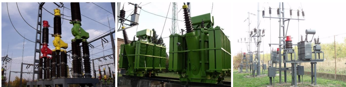
3. ábra: OTKF 4001 120/1000 típusú megszakító; „A” transzformátor; kitáplálási mezők.
