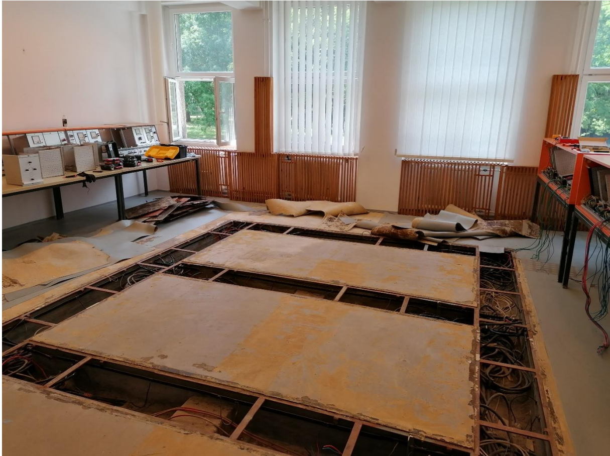
9. ábra: A labor padlójában található kábelvezető akna a benne lévő rézkábelekkal.
