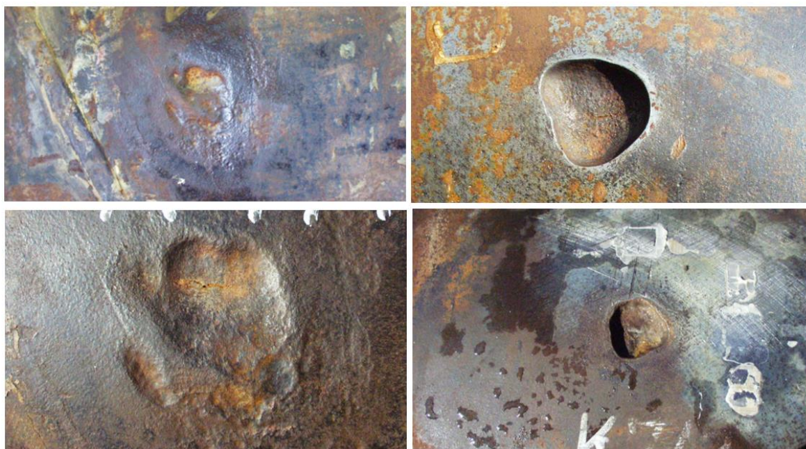
1. ábra. Csőpaláston kialakult tipikus korróziós hibák [4]–[6].
